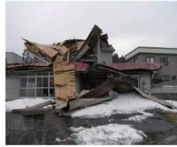
積雪により屋根が落下した空き家
