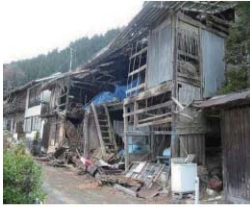
倒壊のおそれのある空き家
