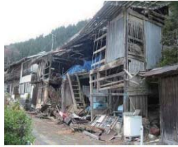
倒壊のおそれのある空き家
