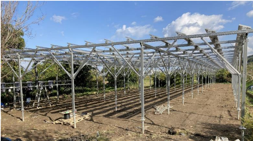
図 9 モデル実証設備の外観
