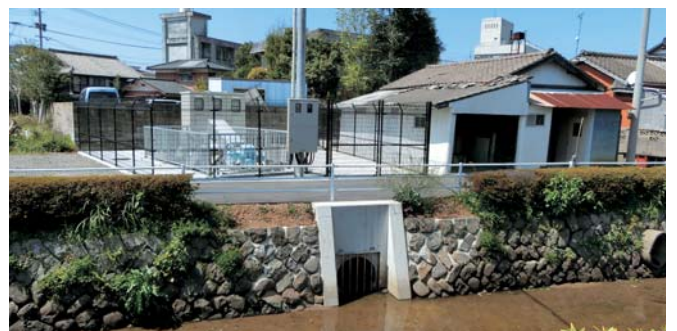
▲丹花 1 号雨水ポンプ場 稼働開始：令和元年 11 月
